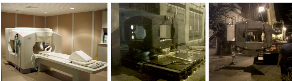
El equipo se desmontó y su gran imán (en la imagen) tuvo que ser manejado con una grúa pesada
